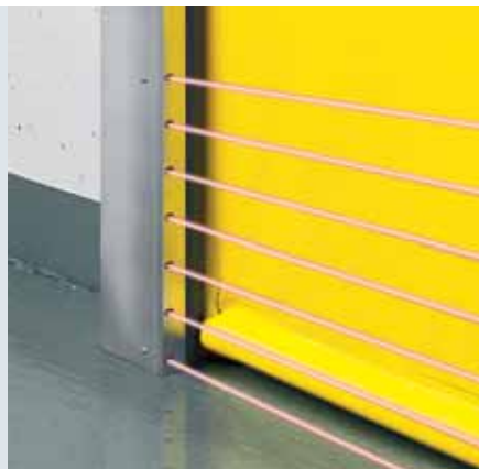
Fényrács rejtetten a kapu tokjába szerelve
